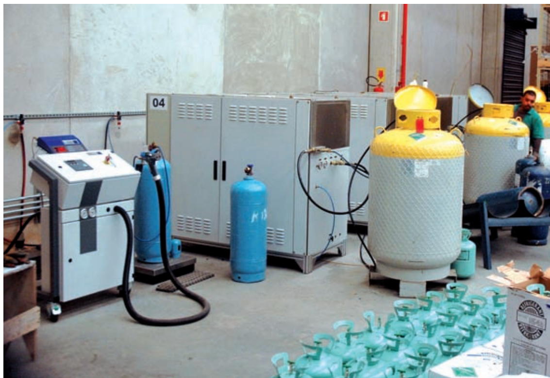
Foram instaladas duas centrais de regeneração de fluidos refrigerantes em São Paulo, uma em Recife, uma no Rio de Janeiro e uma em Porto Alegre
