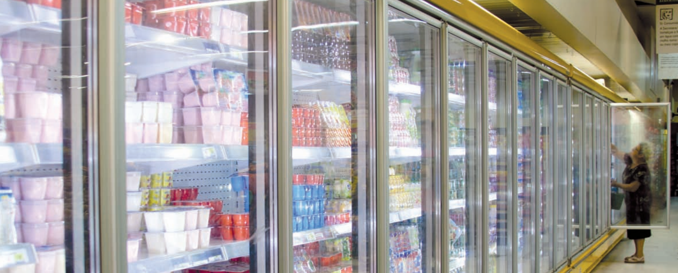
Estabelecimentos comerciais utilizam o HCFC-22 como fluido refrigerante
