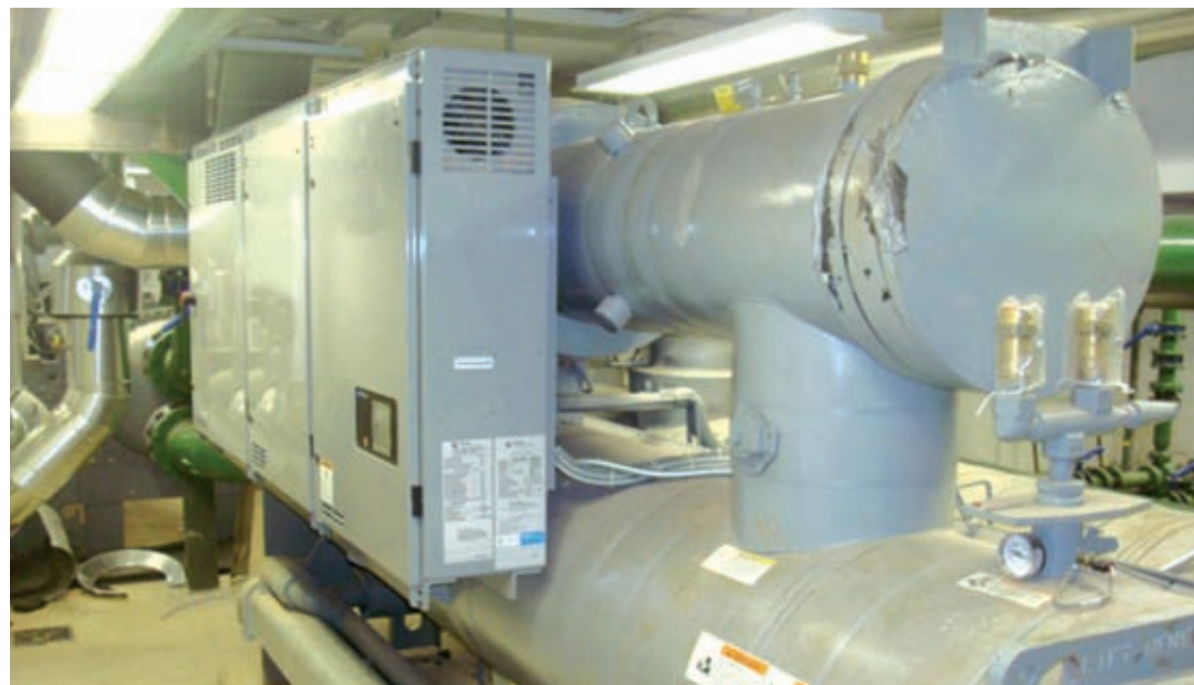
Ar condicionado central com resfriador de líquido, livre de SDOs
